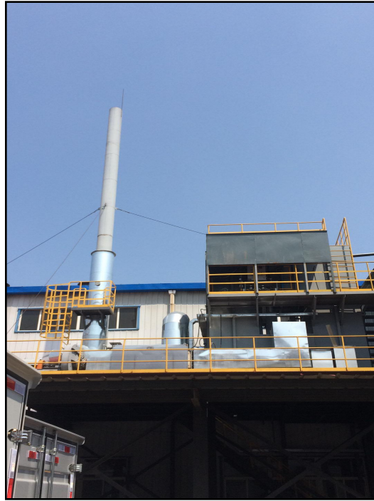
图 3.10 A 区涂装车间烘干废气治理设施及排气筒
