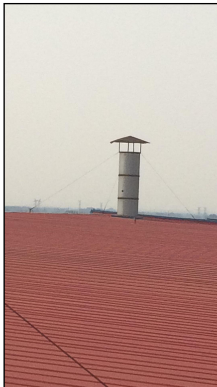
图 3.12 B 区涂装车间打磨粉尘排气筒
