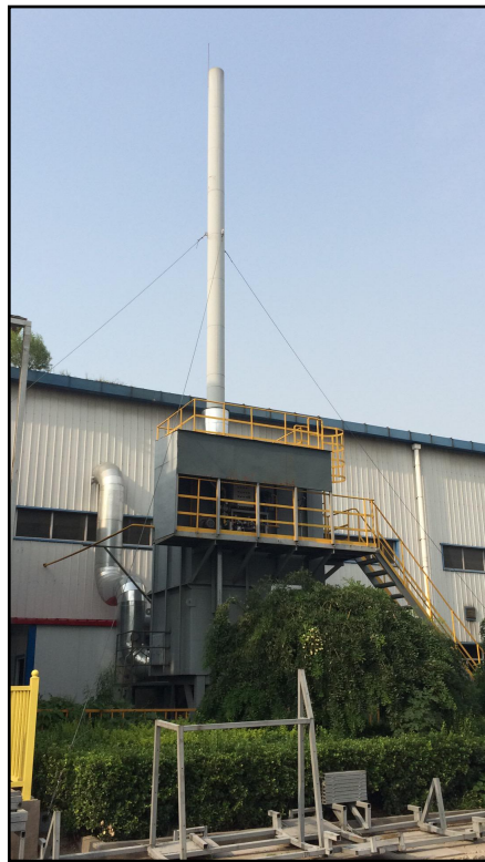
图 3.16 老厂区涂装车间蓄热式热力焚化炉及排气筒
