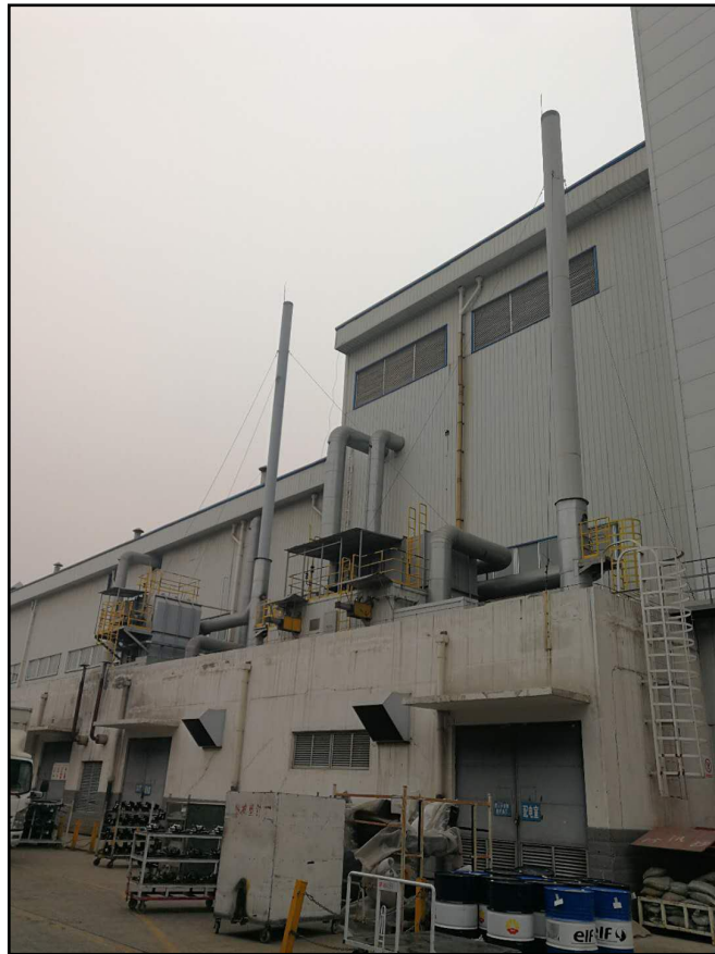
图 3.14 B 区涂装车间蓄热式热力焚化炉及排气筒
