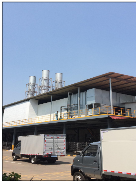
图 3.9 A区涂装车间喷漆废气治理设施及排气筒
