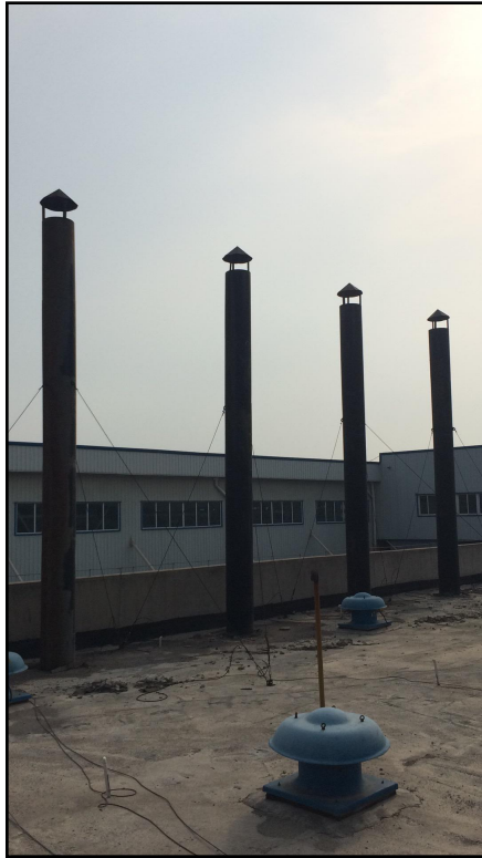
图 3.17 供热站天然气锅炉排气筒
