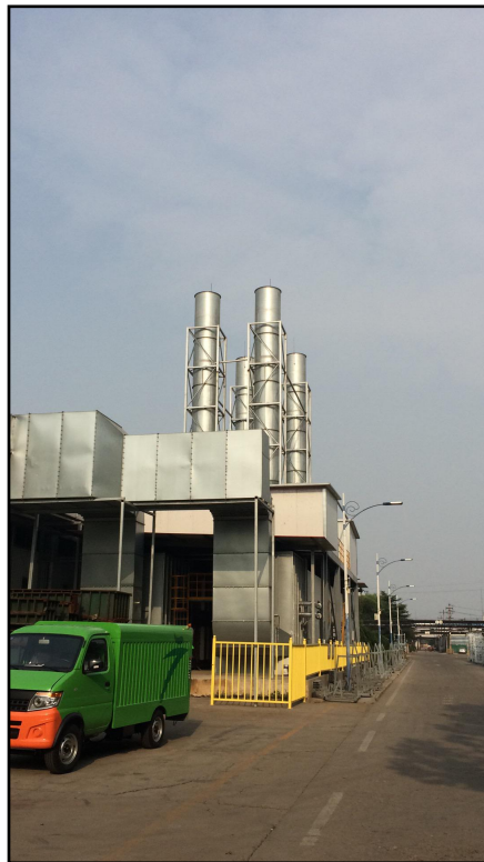
图 3.15 老厂区涂装车间喷漆废气治理设施及排气筒
